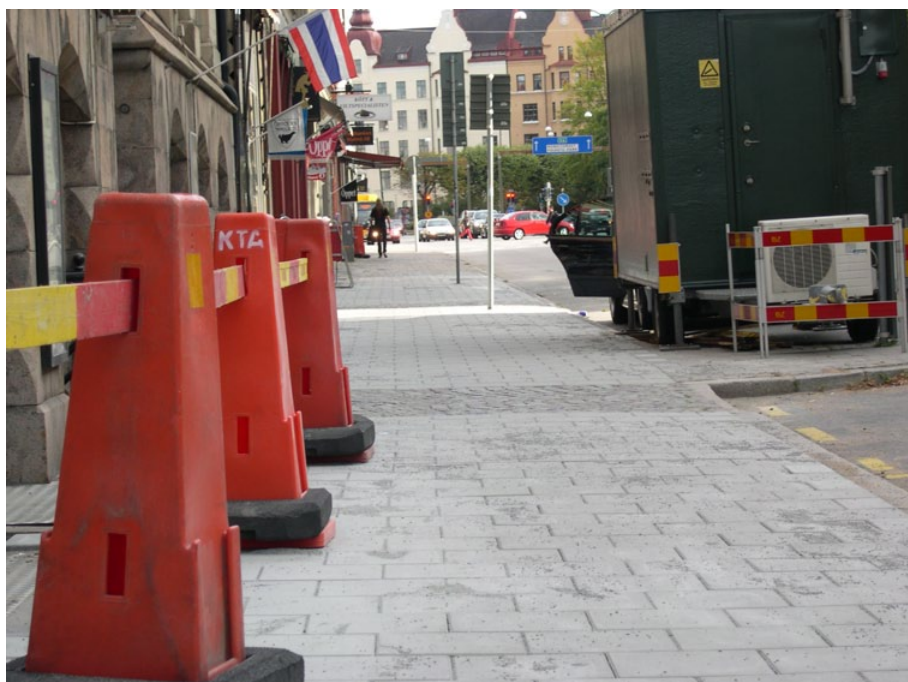
Figur 15. Försök från Amiralsgatan i Malmö där en del av trottoaren försågs med marksten innehållande TiO 2 i ytan visade minskade halter av kväveoxider motsvarande 2000 fordon per dygn.
